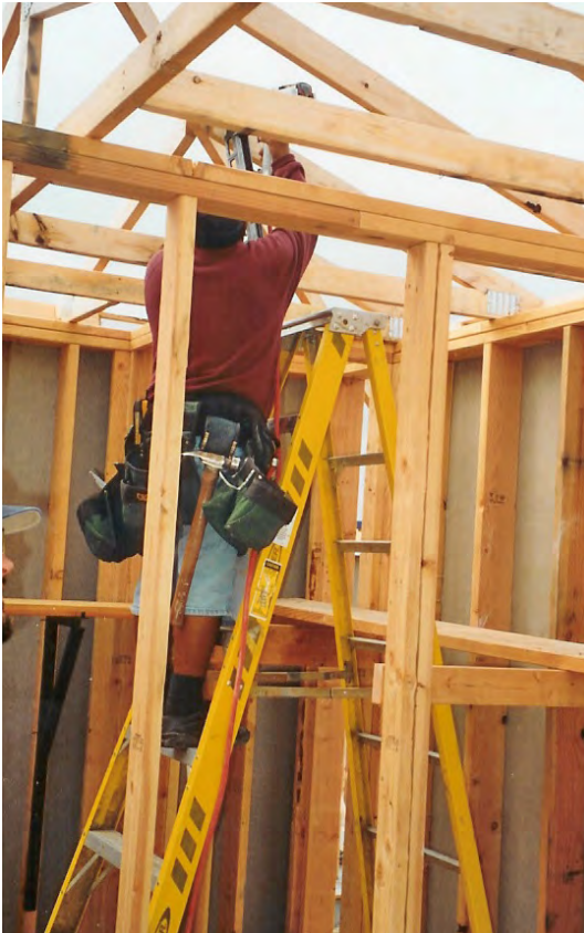
Trabajo en la cúspide desde la placa de apoyo superior de una pared interior.
